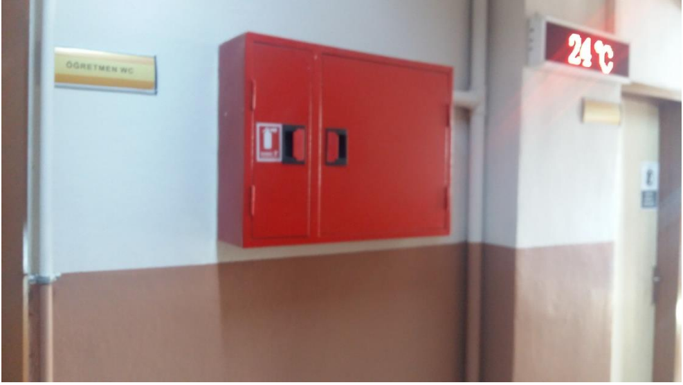
Şekil 2.2: Yangın söndürme tüpü ve hortumu
