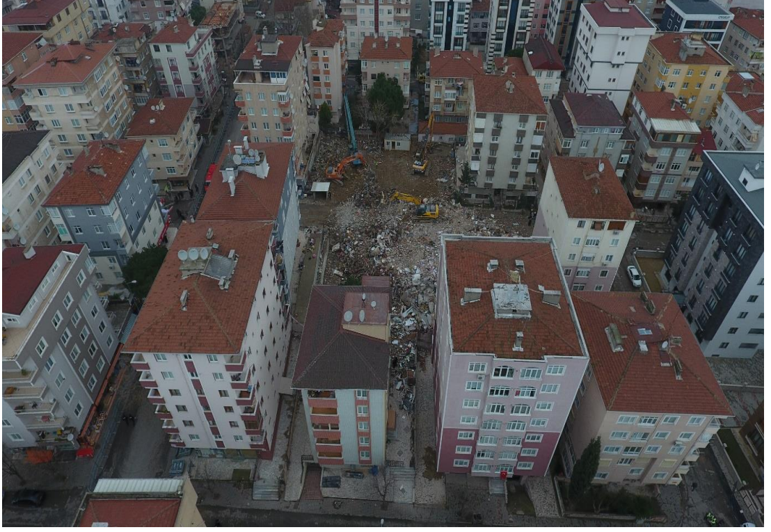
Şekil 39: Yeşilyurt Apartmanı'nın Enkazının Kaldırılmasından Sonraki Görünüm
