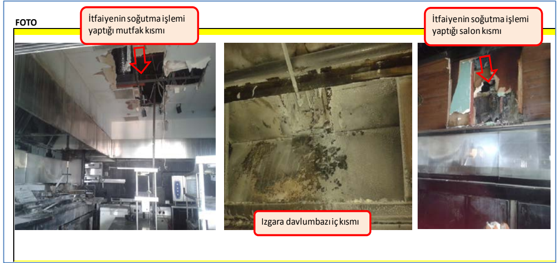
Şekil 4.6: Davlumbaz yangını kaza araştırması
