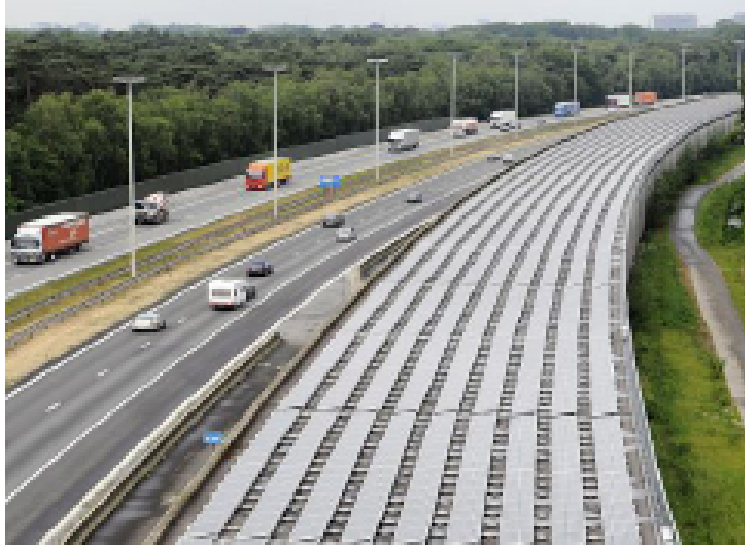
Şekil 29. Paris – Amsterdam Demiryolu Hattı Üzerine Döşenen Güneş Panelleri (Yıldız, 2003)
