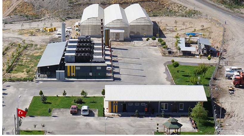
Şekil 4.2: Konya Çöp Gazından Elektrik Üretim Tesisi
