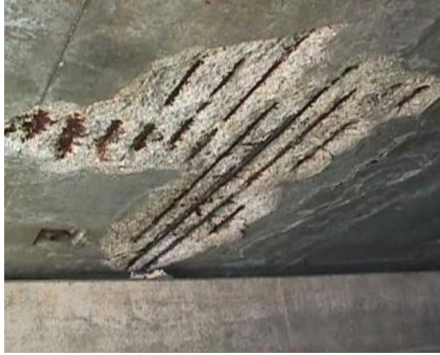
Şekil 10. Donatı korozyonu sonucu donatının açığa çıkması.
