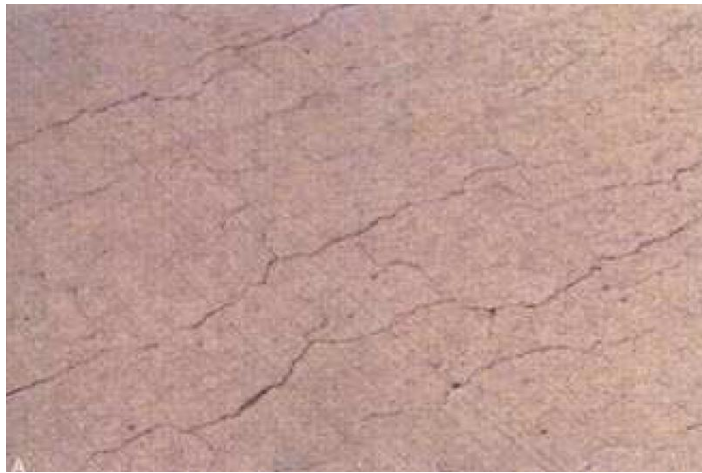
Şekil 16. Alkali-silika tepkimesi hasarına bağlı olarak oluşan çatlaklar.
