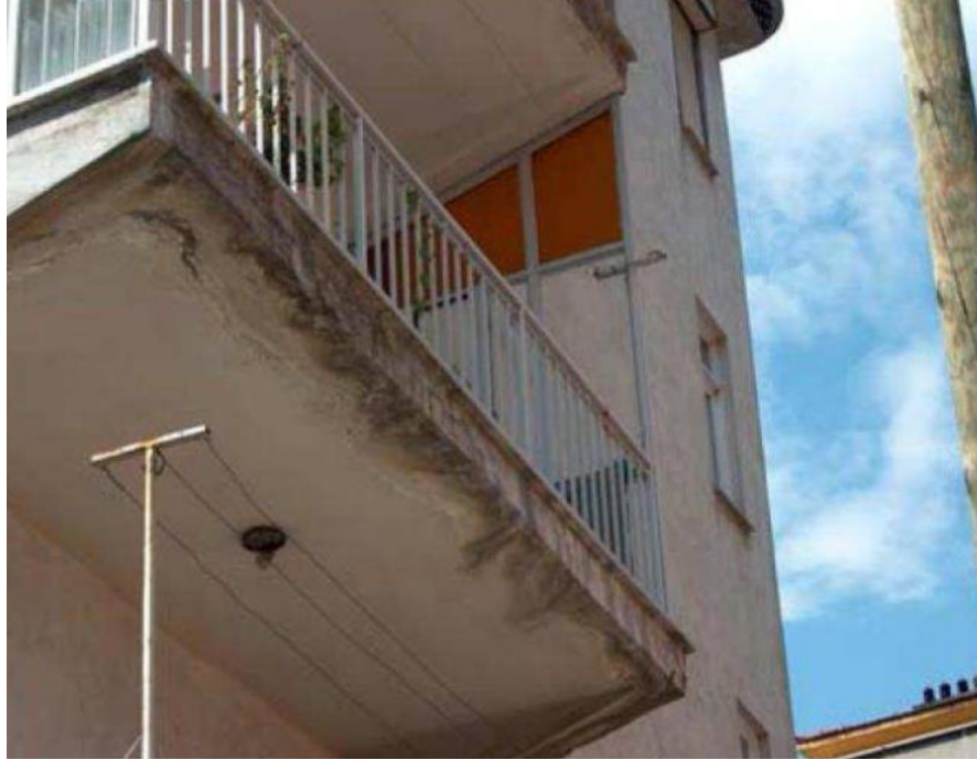
Şekil 8. Damlalık yapılmadığı için bina cephesinde oluşan hasar.
