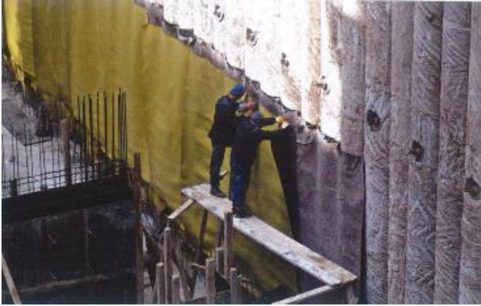
Şekil 48. İksa sistemine su yalıtımı, yanlış uygulama.
