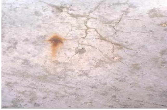
Şekil 11. Donatı korozyonu sonucu pas tabakasının beton yüzeyine sızması.
