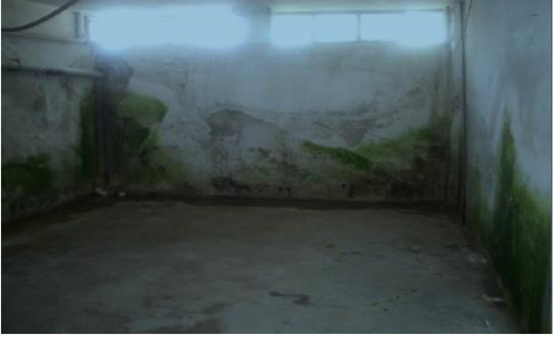
Şekil 14. Bodrum kat duvarlarında oluşan hasarlar.
