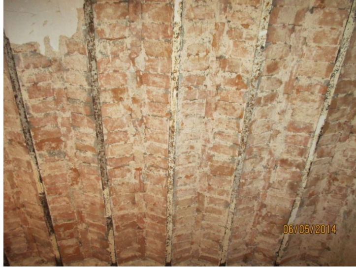
Şekil 5.79: Bodrum katta ıslak hacimlerin volta döşeme tavanı, raspa sonrası
