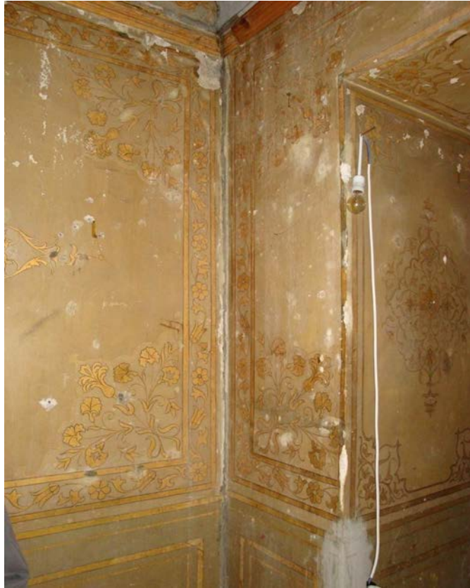
Şekil 5.50: Mahfil katında 1.0m kalınlıkta duvar ile 18.5cm kalınlıkta duvar birleşiminde oluşan düşey ayrılma, 2015
