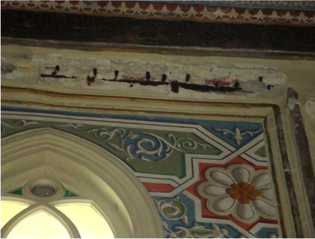
Şekil 5.23: Harim mahalinde sol üst kotta korozyona uğrayan demir aksam, mevcut durum, 2014
