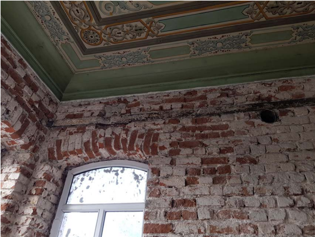
Şekil 5.52: Harim dairesinin çıkmasında ortaya çıkarılan pencere üzerinden geçen duvar gergileri
