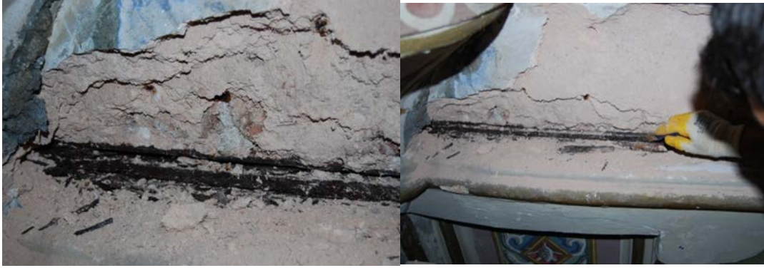
Şekil 5.27: Korozyona uğrayan ve ciddi kesit kaybı oluşan metal elemanlar, 2017
