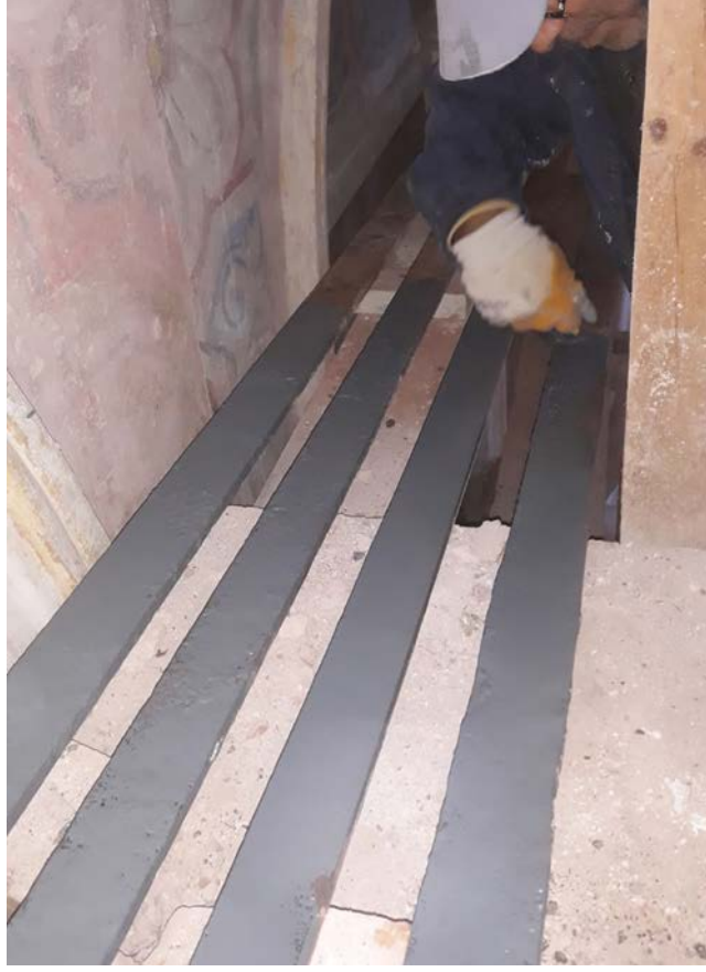
Şekil 5.35: Silme altındaki hasarlı ve korozyona uğramış demir lama ve gergilerin çürütülerek yerinden çıkarılması ve Mekânîk temizlik sonrası koruyucu antipas sürülmesi
