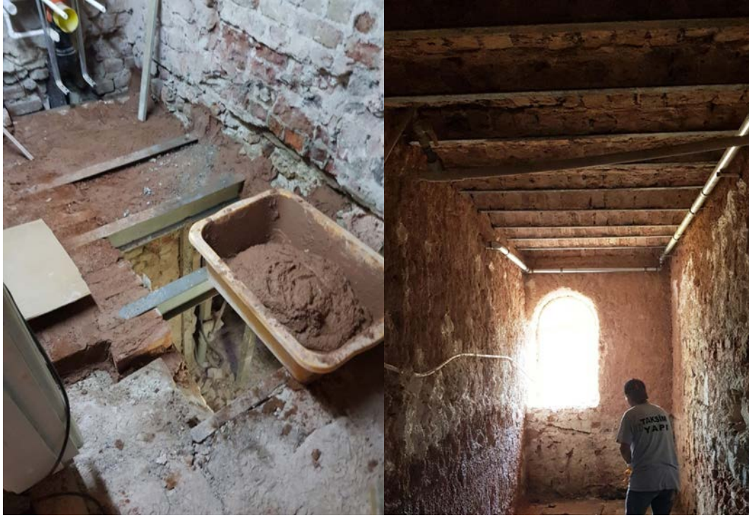
Şekil 5.80: Bodrum katta ıslak hacimlerin volta döşeme tavanı, raspa sonrası
