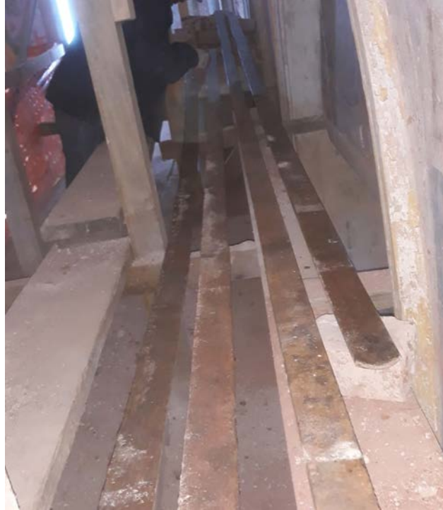
Şekil 5.36: Silme altındaki korozyona uğrayan demir lama ve gergiler
