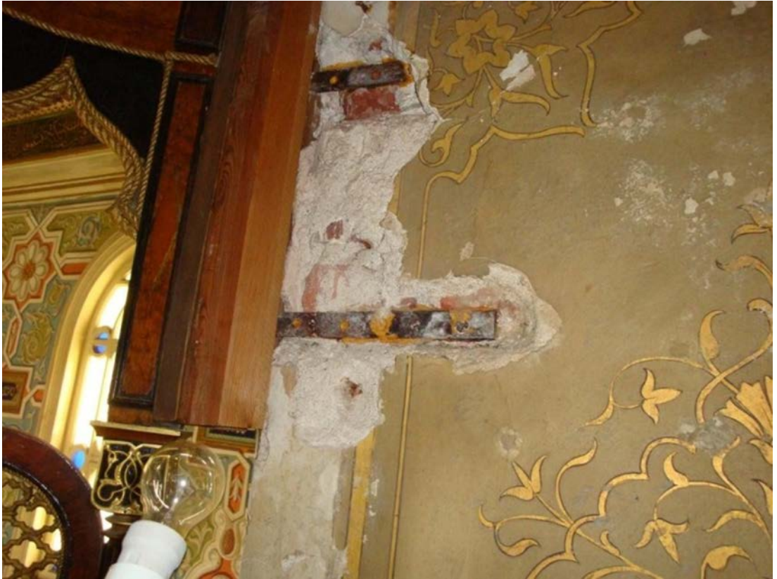
Şekil 5.48: Mahfil katında yer alan Hünkâr mahfilinin duvar birleşim yerlerinde metal elemanlarda korozyon, duvarda çimento harcı ile yapılan onarım, 2015
