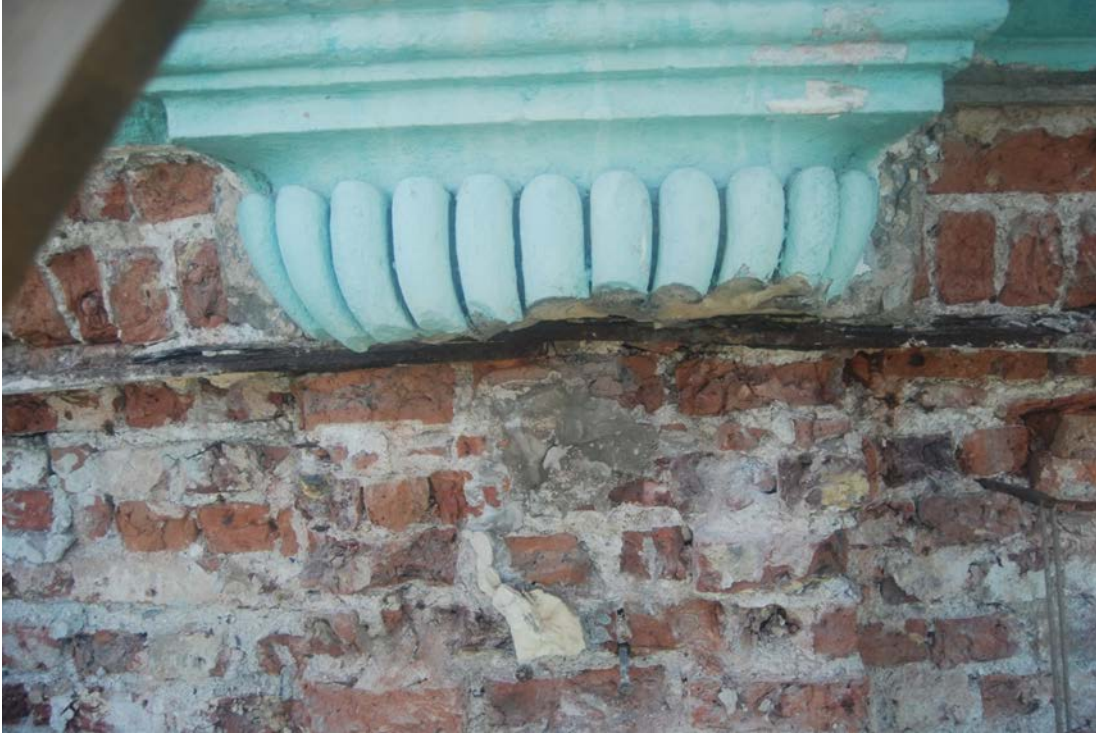
Şekil 5.43: Harim dış cephede raspa sonrası açığa çıkarılan gergiler
