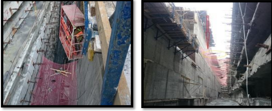
Şekil 4.1: Yüksekten düşme ağda kalma iş kazası. [Eroğlu Holding, Skyland İstanbul İnşaat Arşivi]
