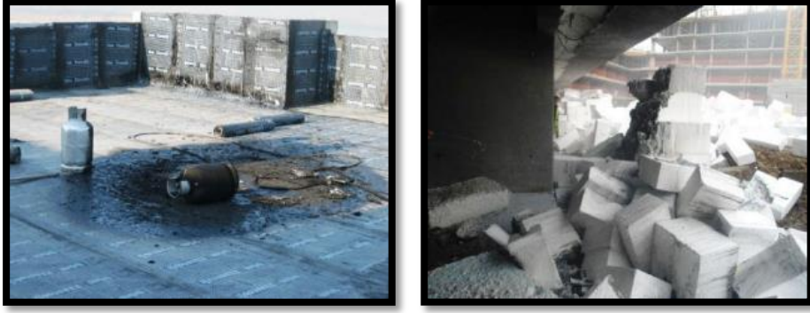
Şekil 3.1: İzolasyon çalışması şaloma yangını ve asmolen yangını. [Eroğlu Holding, Skyland İstanbul İnşaat Arşivi]
