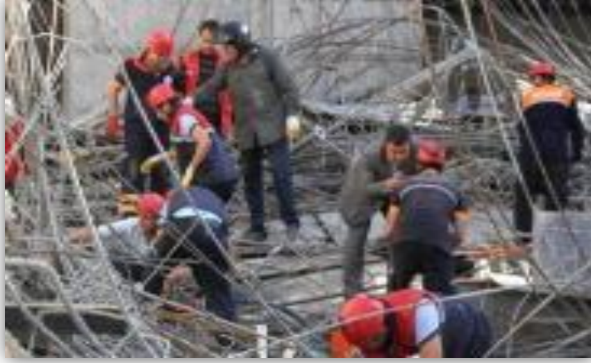
Şekil 4.4: Balıkesir Üniversitesi hastane inşaatında kalıp iskelesi çökmesi ( http://politeknik.org.tr/hastane-insaatinda-kalip-iskelesi-coktu-4-isci-hayatini-kaybetti/ , 2017)
