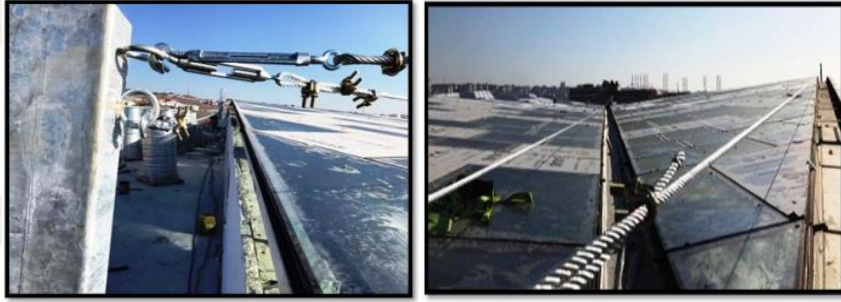
Şekil 2.2: İşletmede çatı temizliği için tasarım aşamasında can halatı planlaması. [Eroğlu Holding, Skyland İstanbul İnşaat Arşivi]
