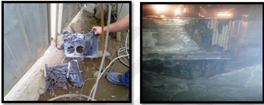
Şekil 3.2: Pano yangını ve kaynak çapağı yangını. [Eroğlu Holding, Skyland İstanbul İnşaat Arşivi]
