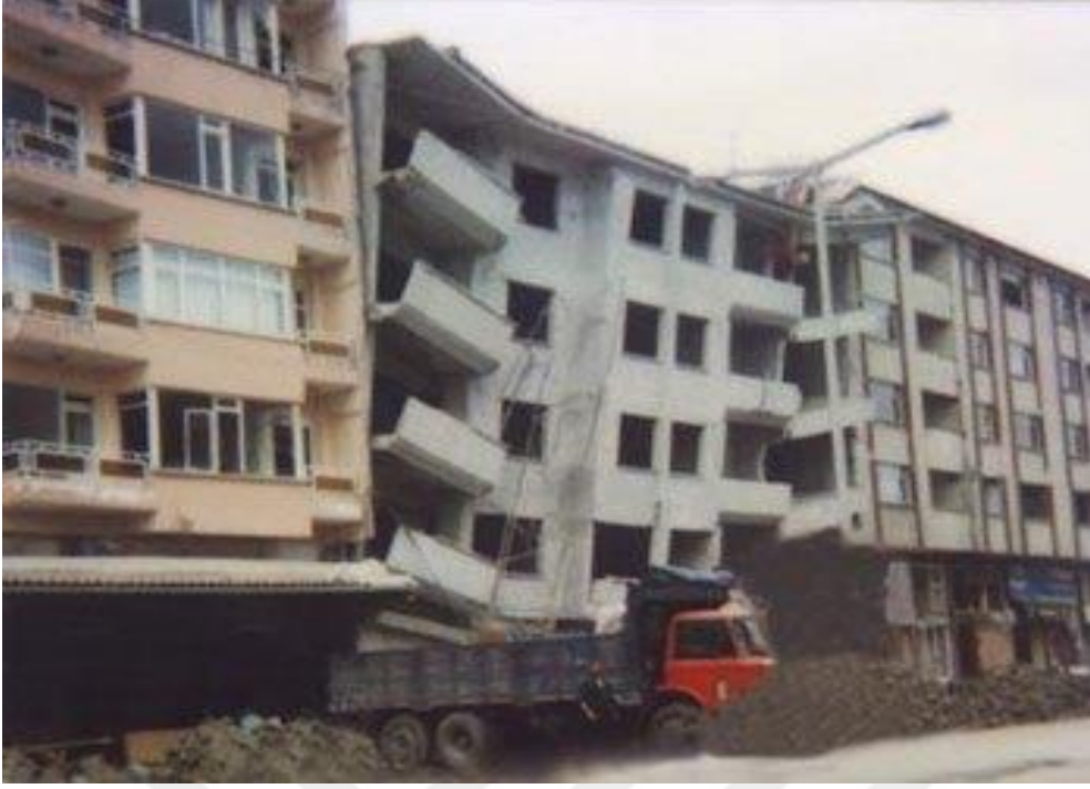
Şekil 2.13: Çekiçleme etkisi nedeniyle hasar gören yapılar
