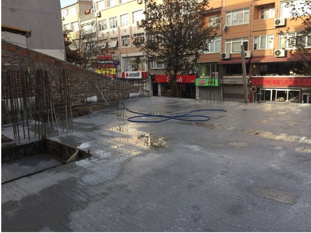
Şekil 5 Yeterince suya doymamış ve düzeltilmemiş betonarme döşeme örneği (Cenik, 2016).
