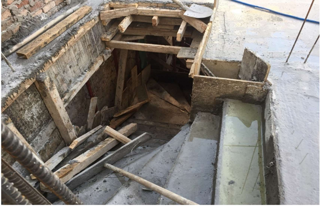
Şekil 33 Beton dökümü sonrası ortaya çıkan kalıp beton atığı (Cenik, 2016).
