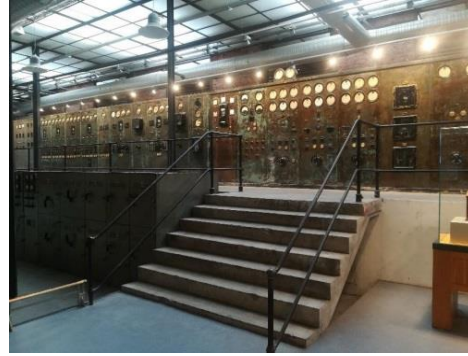
Şekil 76. Seka Kağıt Müzesi Elektrik Kontrol Panosu
