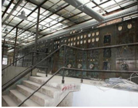
Şekil 77. Kağıt Fabrikası Elektrik Kontrol Panosu
