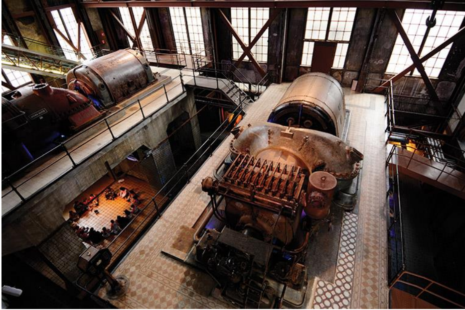
Şekil 112.Santral İstanbul Enerji Müzesi Korunan Elektrik Üretim Ekipmanları (Kaynak: https://www.santralistanbul.org/tr/ , 2023 )
