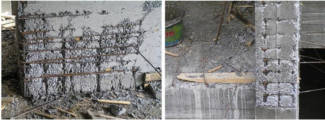
Şekil 55. Segregasyon hasarları ve paspayı kusurları
