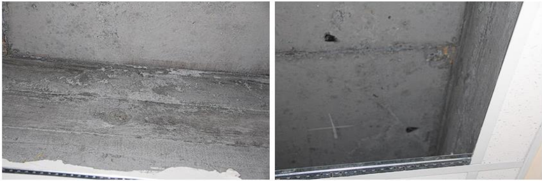
Şekil 53. Hasar olmayan taşıyıcı elemanlar ve birleşim bölgelerinden görüşler
