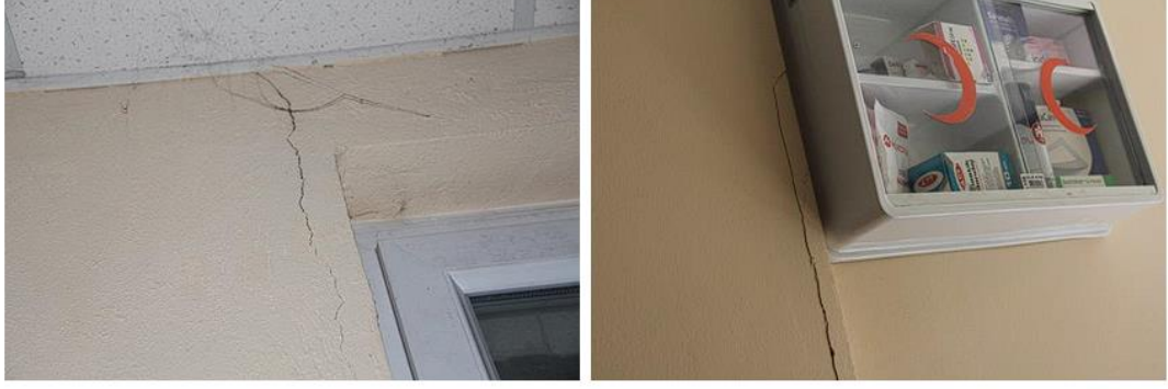
Şekil 54. Taşıyıcı elemanlarda gözlemlenen kısmi hasarlar
