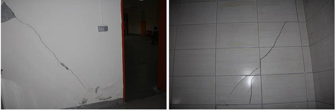
Şekil 52. Taşıyıcı olmayan elemanlarda (duvarlarda) bulunan hasarlar
