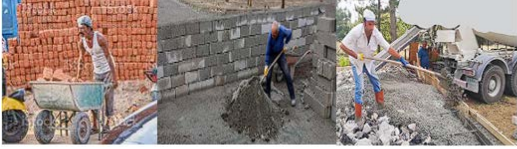
Şekil 30. İnşaat yaparken yetersiz ekipmanlar kullanılması ( http://megep.meb.gov.tr , 2022).
