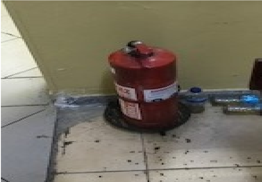
Şekil 49. Atölyede Kullanma Tarihi Geçmiş ve Boş Yangın Tüpü
