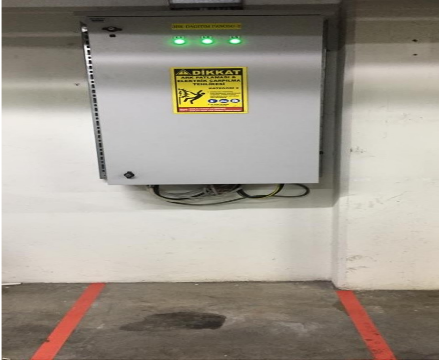
Şekil 52. Atölyede Bulunan Yalıtkan Paspasız Tehlikeli Elektrik Panosu
