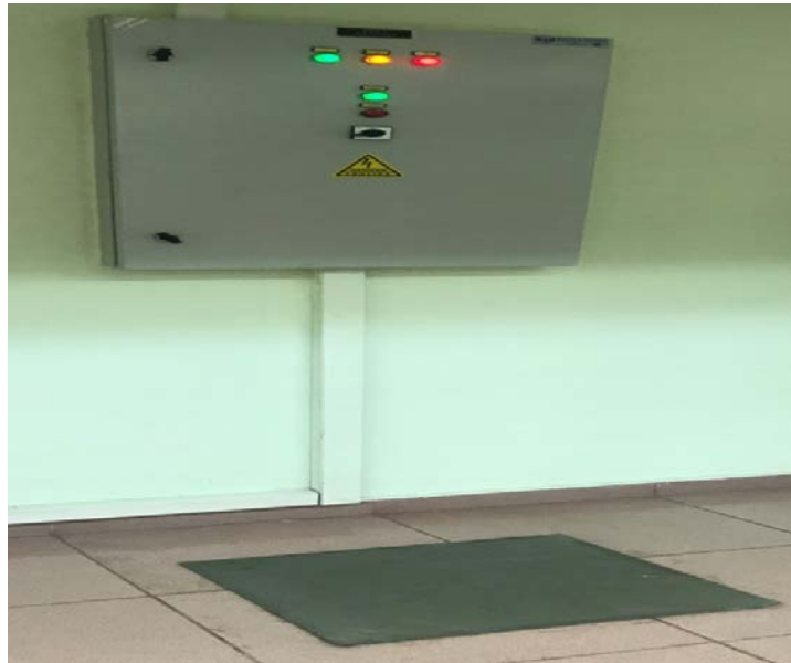
Şekil 51. Yalıtkan Paspaslı Güvenli Olması Gereken Elektrik Panosu
