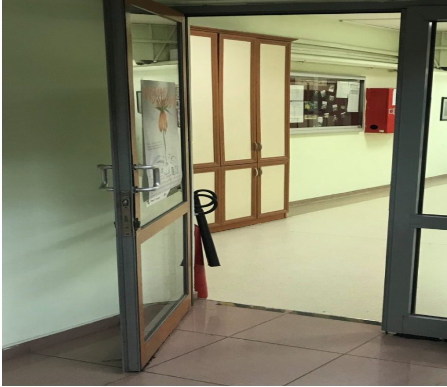
Şekil 35. Atölyede Tehlikeli İçeri Açılan Kapı
