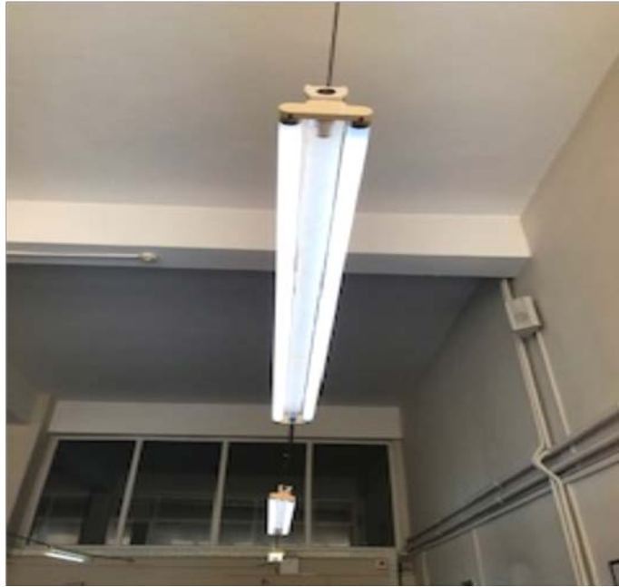
Şekil 34. Güvenilir Olmayan Aydınlatma Lambası
